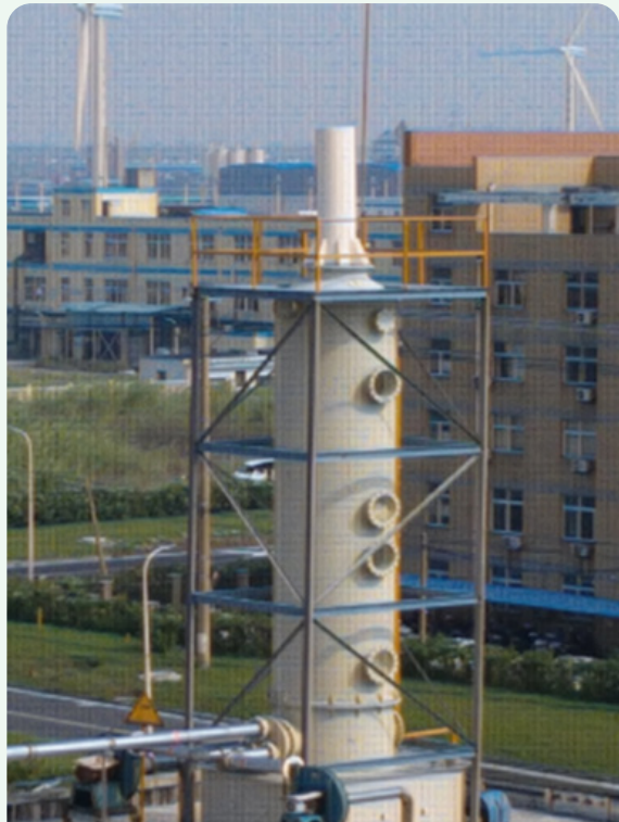
布袋除尘 + 水喷淋塔
